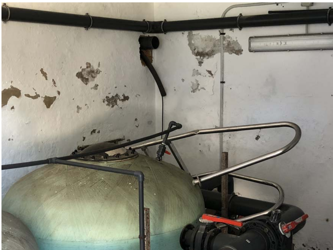
Sala de depuración. Entrada de tubería de skimmers para conectar nuevos rebosaderos.
